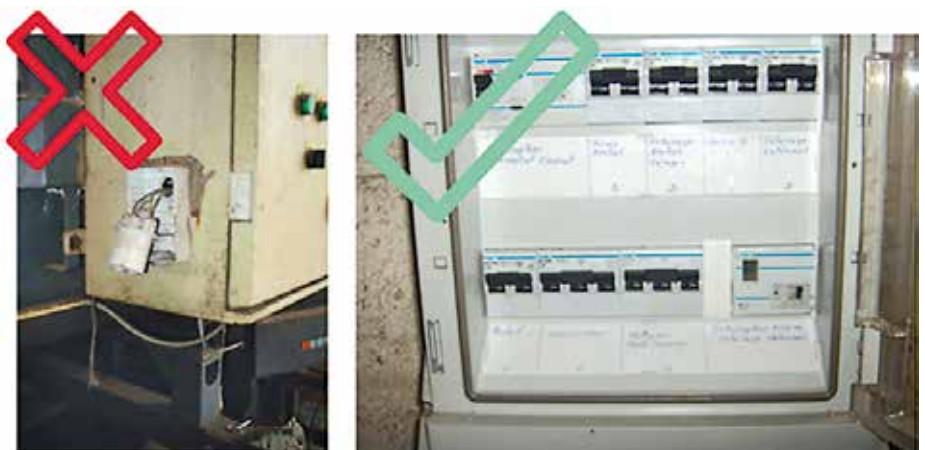
Fig. 1. Een goed afgesloten elektriciteitskast die stofvrij is en waarbij de kabels geen gebreken vertonen is een must. (Bron: PreventAgri)
