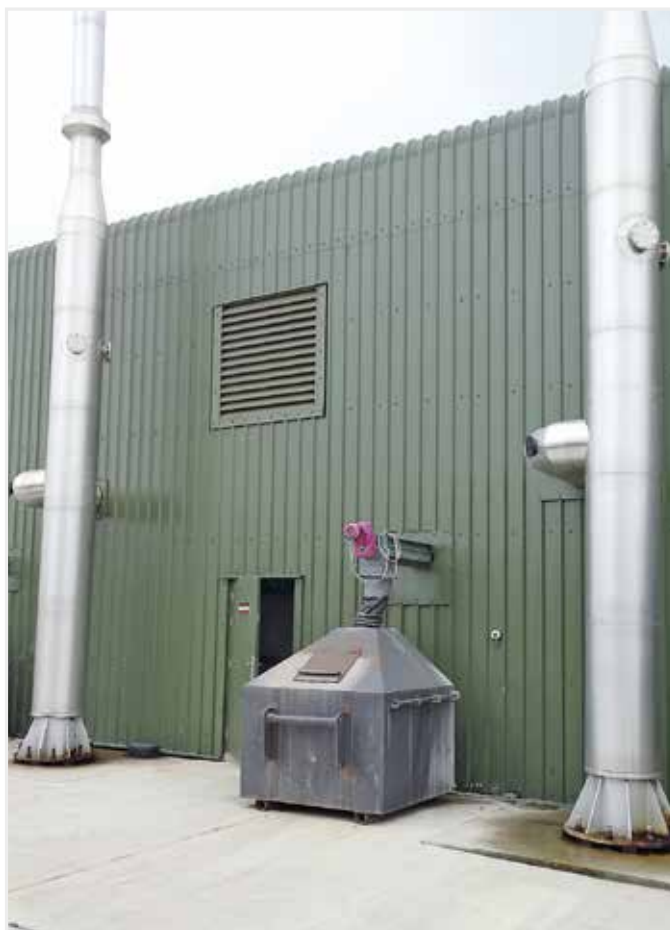
Buitenzicht van de verbrandingscentrale op basis van houtchips. Twee branders (1,2 MW) en de 2 warmwaterboilers (9.000l op 90°C) zorgen voor de verwarming van het volledige complex. Bemerkt vooraan de 'asbak'.
