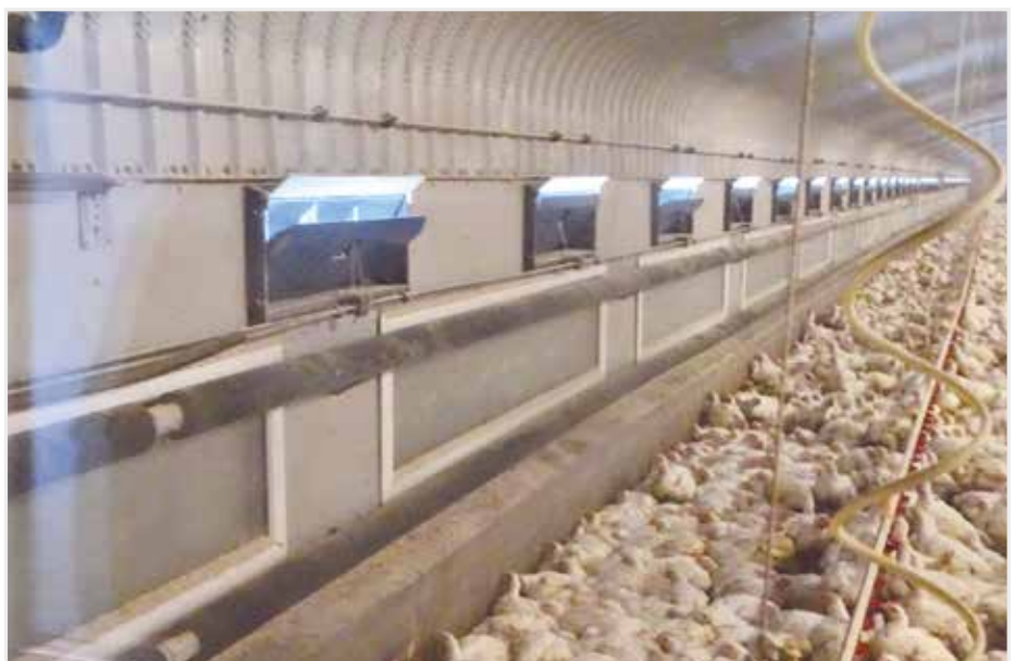
De verwarming is d.m.v. Spiraflex buizen, die boven en onder de rij afsluitbare vensters geplaatst zijn. Bemerkt verder de nevelkoeling boven de luchtinlaten.
