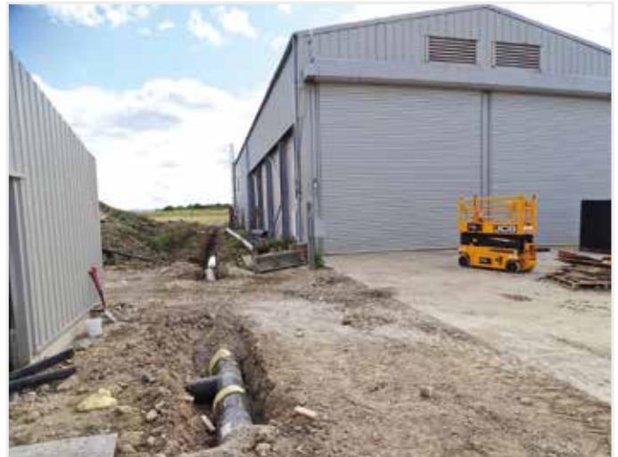
Een biomassaverbrandingsinstallatie voedt de Spiraflex buizen van de 8 stallen, hier is de aanleg naar de nieuwe stallen te zien.
