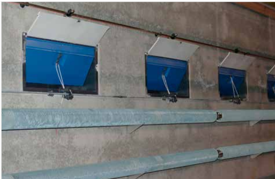
De opbouw aan de zijmuren met de nevelkoeling boven de inlaatventielen en de dubbele rij geribbelde verwarmingsbuizen.
