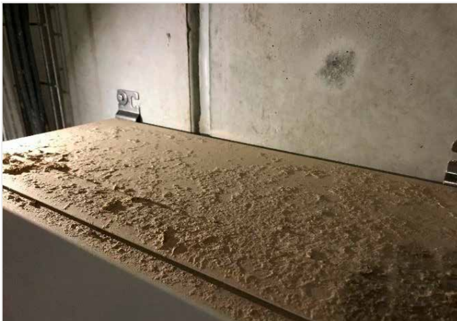
Stof en vuil aan de bovenkant van elektriciteitskasten in de stal.
