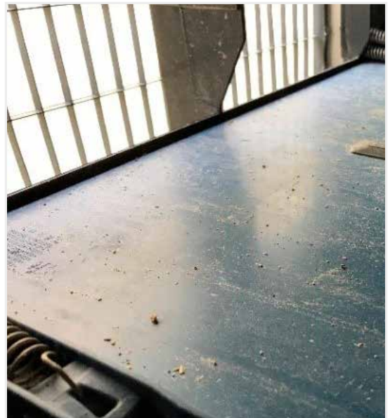
Onvoldoende gereinigde inlaatventielen.
