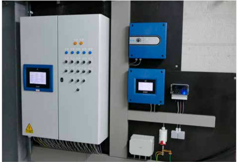
Alle technieken worden aangestuurd door een gebruiksvriendelijke stalcomputer en zijn compact samengebracht in één regelkast.
