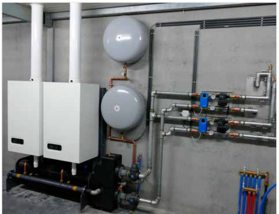
De gasbranders die het buizenverwarmingssysteem voeden zijn zeer compact en geïnstalleerd in de aangebouwde technische ruimte.
