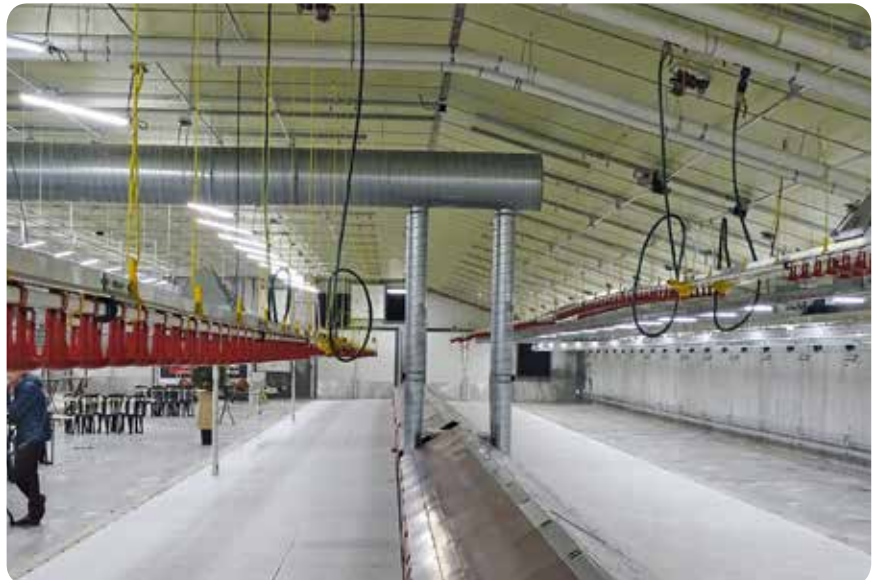
De vele voeder- en drinklijnen kunnen eenvoudig opgelierd worden. Bemerkt ook de mestbeluchting onder de beun dwars in het midden van de stal.
