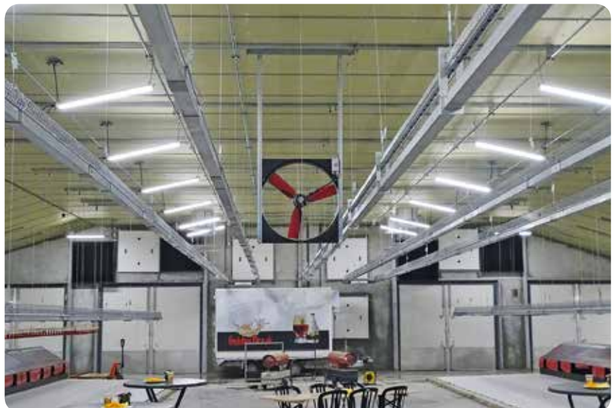
In de achtergevel zijn 6 ventilatoren geplaatst, op de foto afgedekt met een witte luchtdichte isolatieplaat. Ernaast hangen de zwarte lichtfilters die voor de ventilatoren geplaatst worden wanneer deze in werking gesteld worden.
