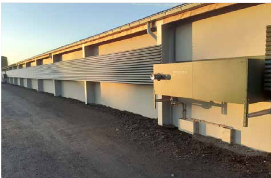
Gasbranders buiten de stal zorgen voor een gesloten verbrandingscircuit waarbij geen CO 2 of waterdamp in de stal terechtkomt.
