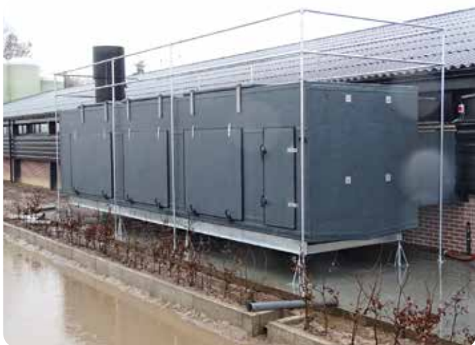
Een VGF-Technics warmtewisselaar is halverwege aan de zijkant van iedere stal geplaatst.
