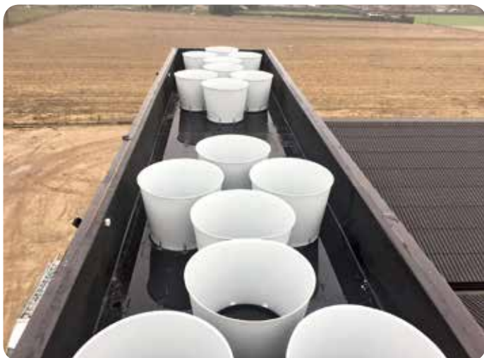
Achteraan de stallen is er een hoge aanbouw waarin de Reventa ventilatiekokers met een uitlaathoogte van 10 meter geplaatst zijn. Zicht bovenaan.
