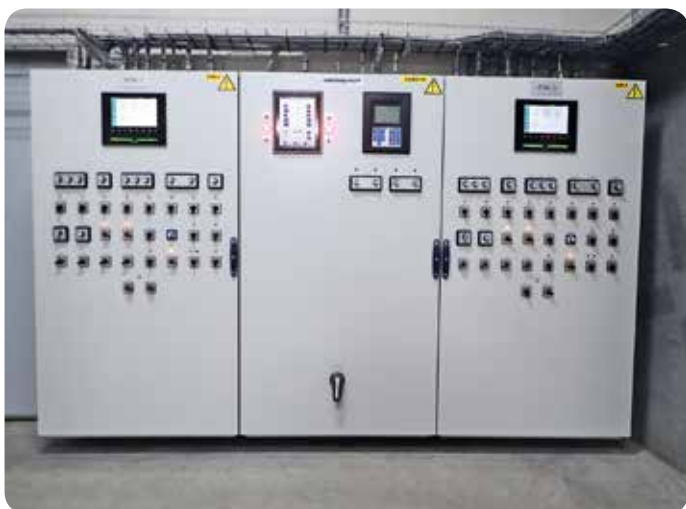
In de gezamenlijke technische ruimte zorgen de Stienen PL9500 Touch computers samen met de PFA-9200 voercomputer voor aansturing van de verschillende processen.
