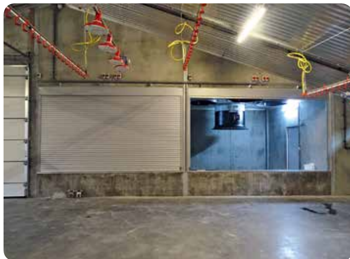
Binnenzicht achteraan de stal van de stofbak met de ventilatiekokers en de automatisch afsluitbare rolluiken.
