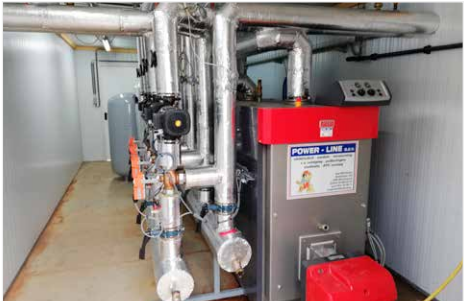
In een container, tussen stal 3 en 4, zorgt een imposante mazoutbrander voor de aanvoer van warm water naar het buizenverwarmingssysteem.
