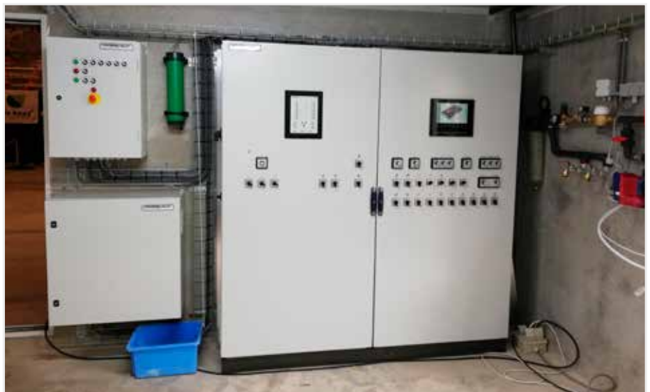
Alle technieken en regelingen werden uitgevoerd door Droeshaut. Hier is de regelkast en de Stienen PL-9500 managementscomputer te zien.
