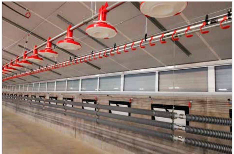
Het buizenverwarmingssysteem is oplierbaar. Verder is de lichtstraat opvallend, de lijnen nevelkoeling en de flow slider voerpannen.
