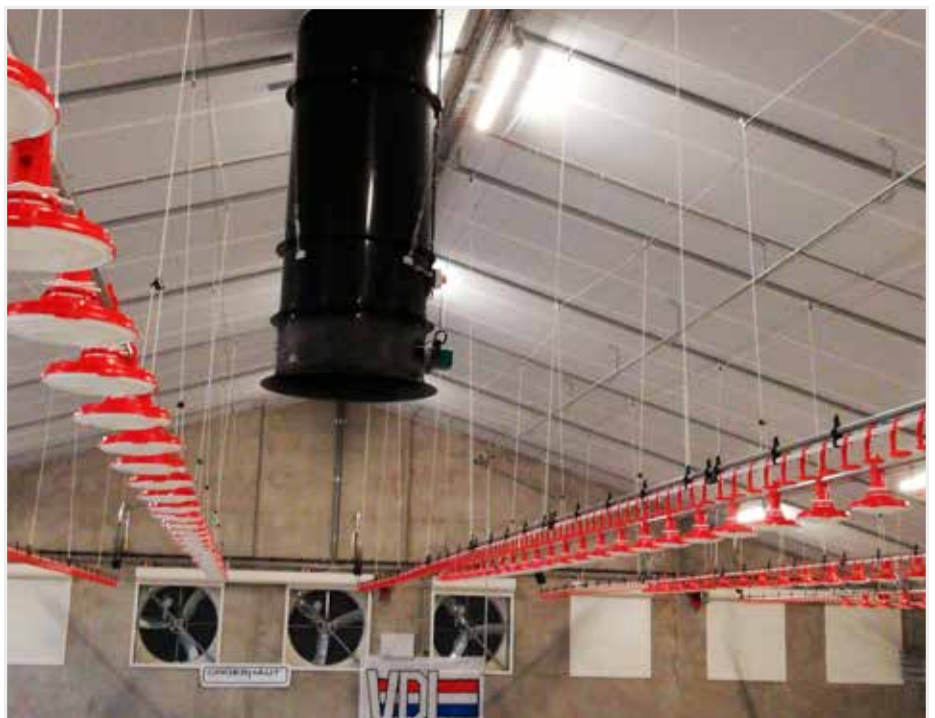
De combiventilatie bestaat uit een minimumventilatie door 4 dakventilatoren aangevuld met 9 'Fiber glass' ventilatoren in de achterwand.
