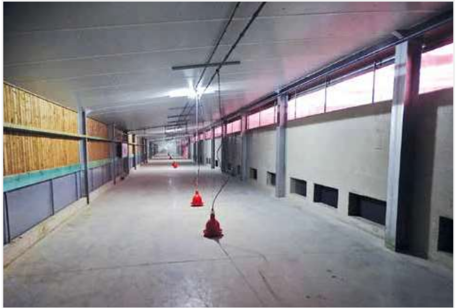
In legkippenstallen met wintertuin kan extra drinkwatergelegenheid en eventueel nevelkoeling soelaas brengen.
